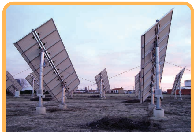
SEGUIDOR SOLAR BIPOSTE
